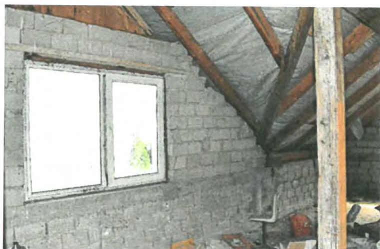
-Lipsa centurii la partea superioară a timpanelor de zidărie
