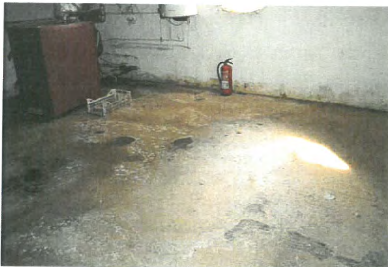
-Degradări la nivelul plăcii pe sol — degradări cauzate de infiltrații de apă
