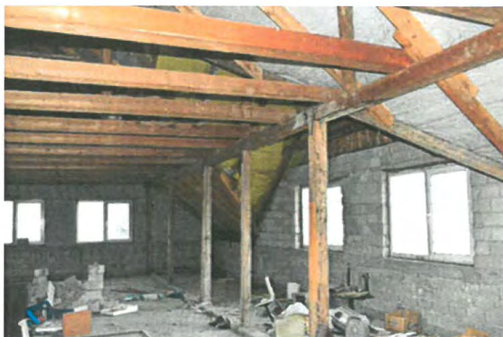
-Deficiențe de alcătuire generală: lipsa contrafișelor la partea superioară a popilor
