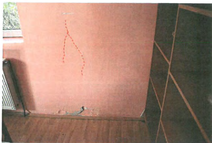
-Degradări la nivelul pereților — dislocări ale tencuielilor și finisajelor, prezența fisurilor
