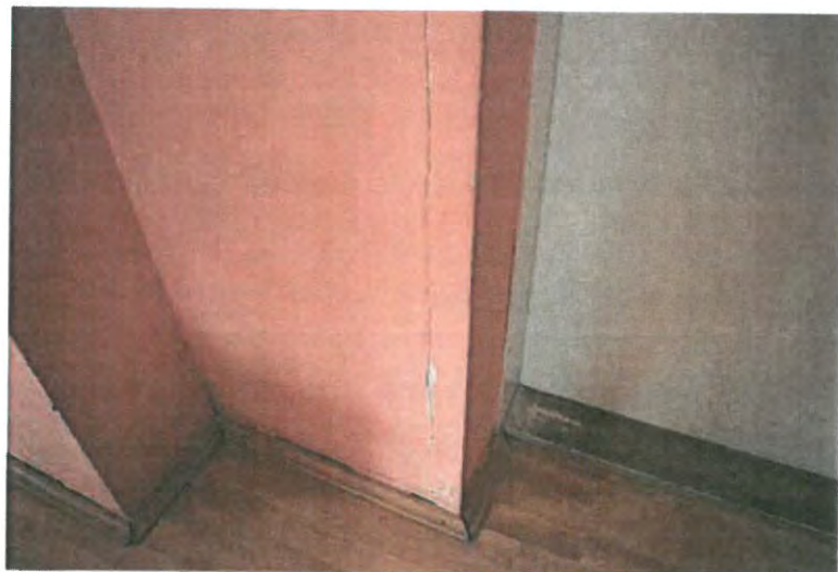
-Prezența fisurilor în zona golului de ușă
