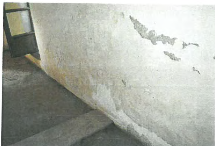
-Degradări la nivelul pereților demisolului cauzate de infiltrații de apă
