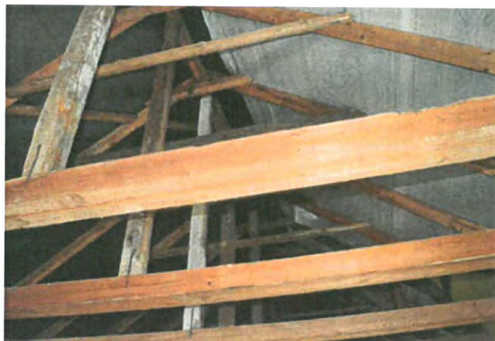
-Deficiențe de alcătuire de detaliu: îmbinări necoqforme între elementele de șarpantă
