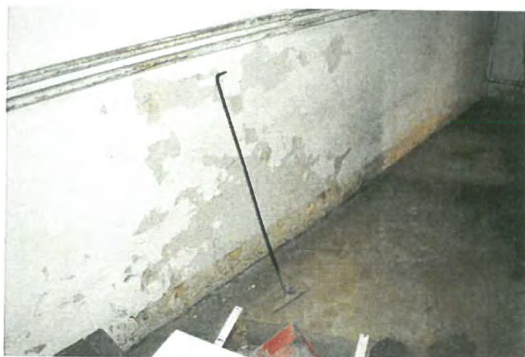
-Degradări la nivelul pereților demisolului — exfolierea finisajelor
