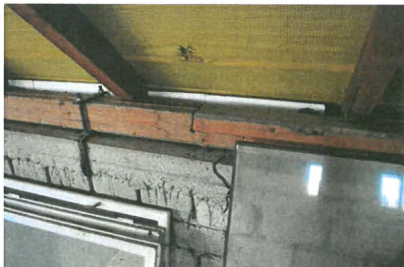
-îmbinare neconformă de continuizare cosoroabă
