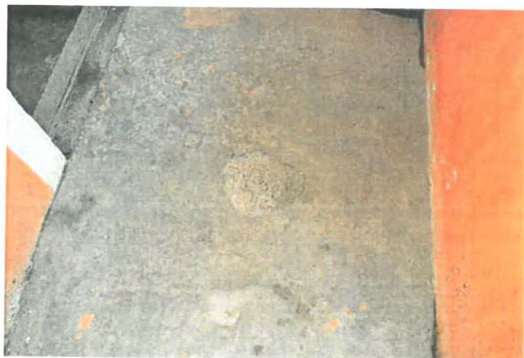
-Degradări la nivelul plăcii pe sol — exfolieri ale betonului
