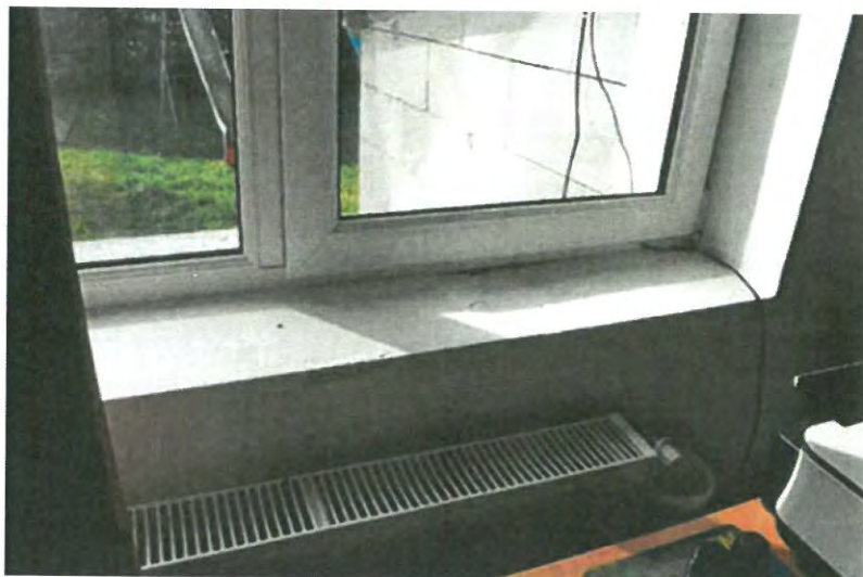
-Degradări cauzate de infiltrații de apă la nivelul parapetului
