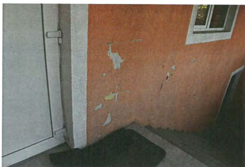
-Degradări la nivelul pereților – exfolieri ale tencuielilor și finisajelor
