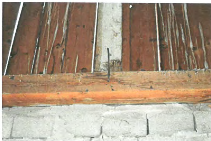
-Elemente de șarpantă degradate din cauza infiltrațiilor de apă
