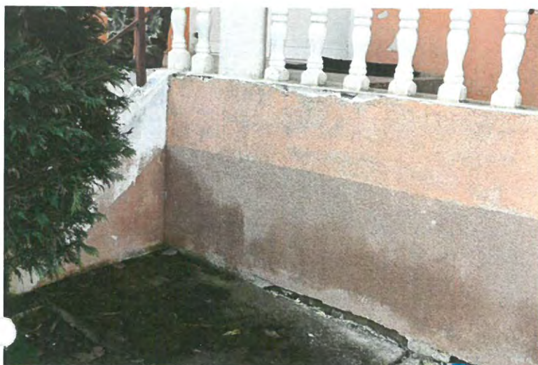
- Degradări la nivelul pereților – degradări cauzate de infiltrații de apă
