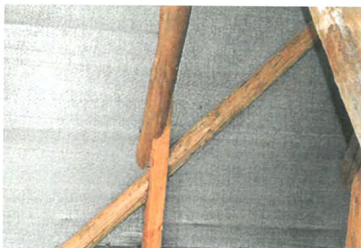
-Deficiențe de alcătuire de detaliu: îmbinări neconforme între elementele de șarpantă
