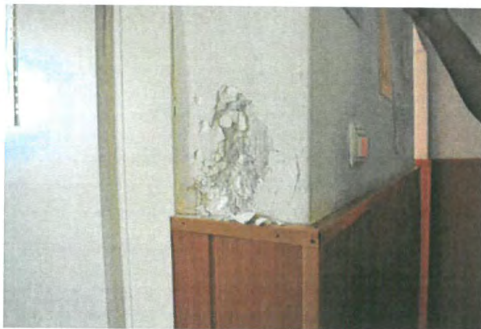
-Degradări în zona golului de ușă dislocări ale tencuielilor și finisajelor
