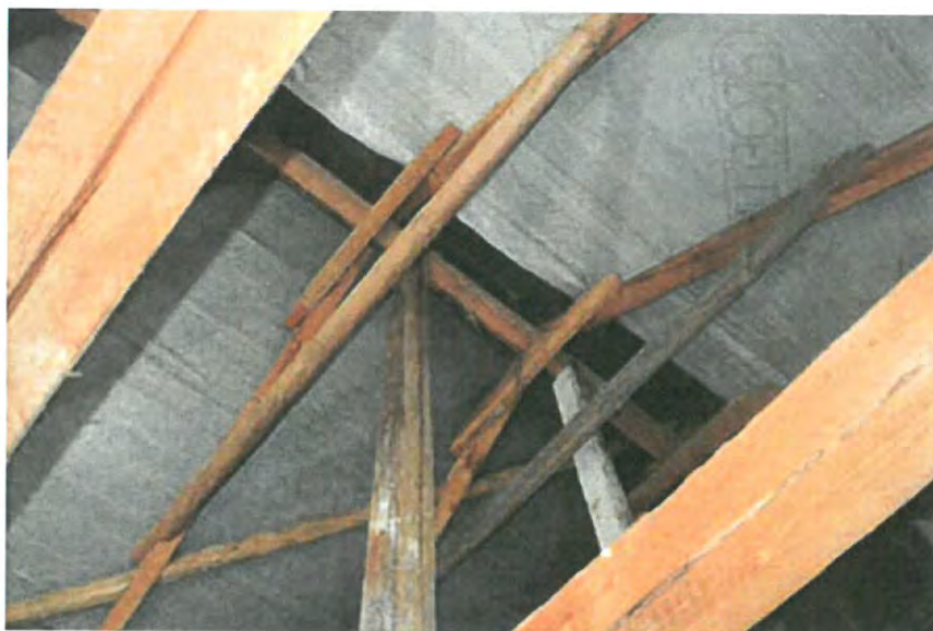
-Deficiențe de alcătuire generală: lipsa cleștilor de o parte și de alta a căpriorilor
